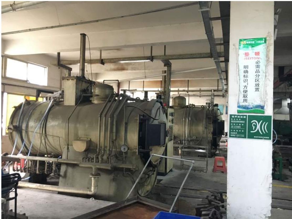
生产设备照片（真空淬火炉）
