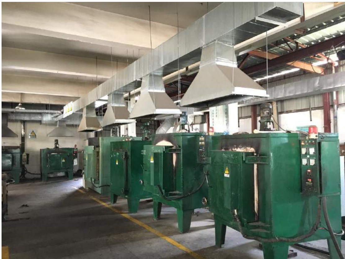
生产设备照片（常规回火炉）
