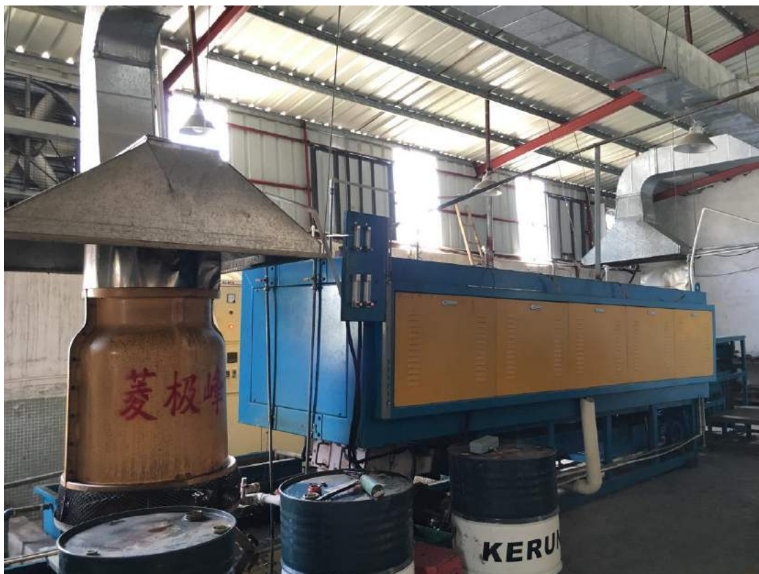
生产设备照片（网带淬火炉）
